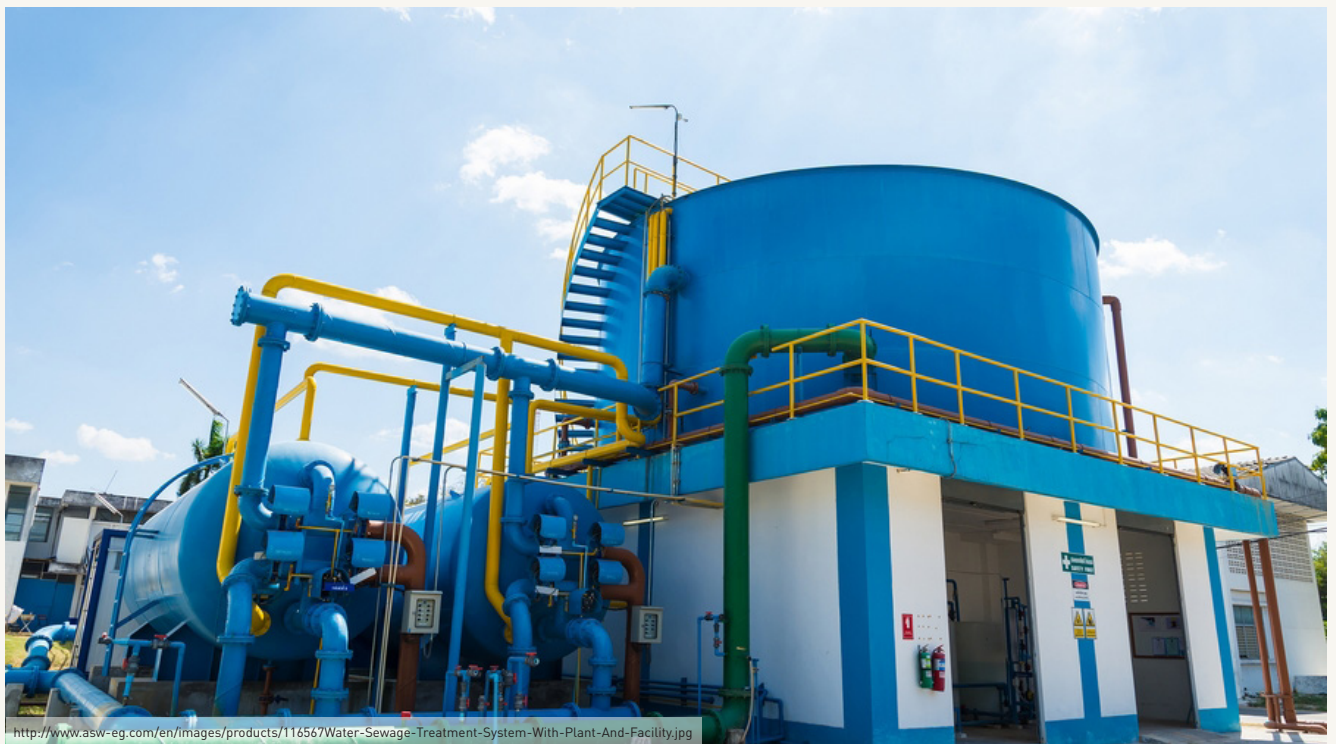
Endüstriyel Atıksu Arıtma Tesisi
