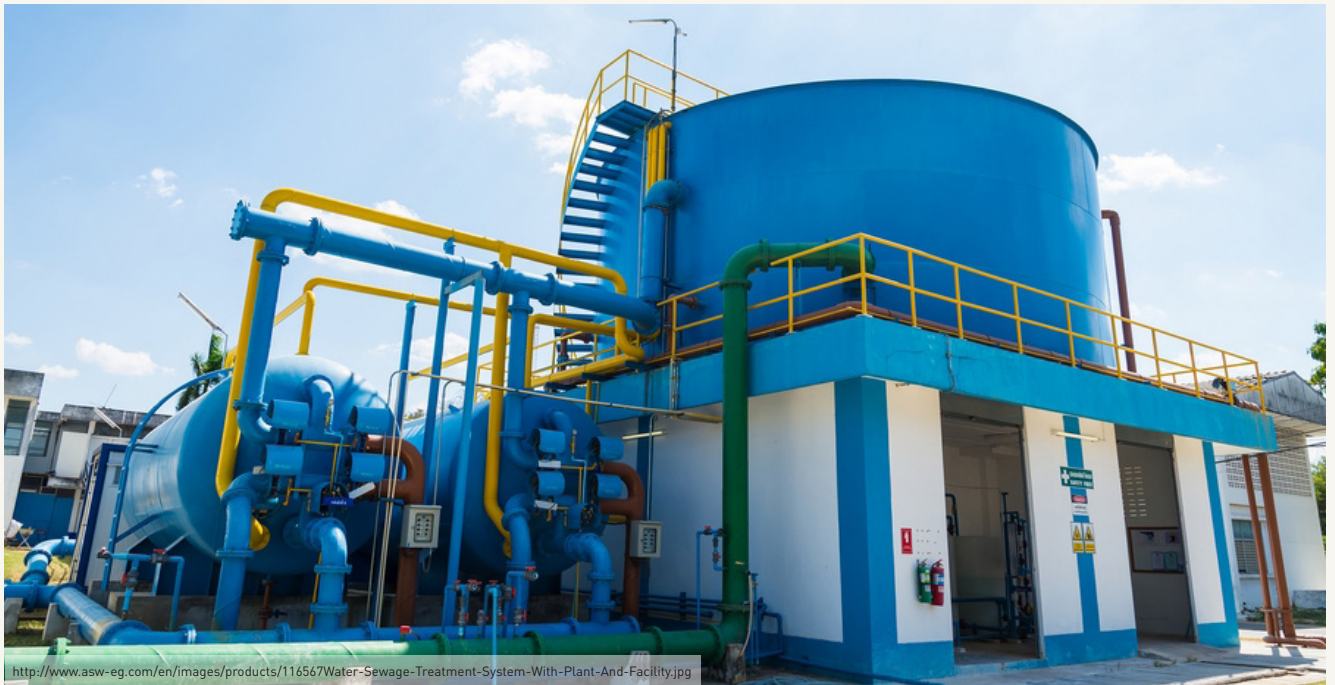
Endüstriyel Atıksu Arıtma Tesisi
