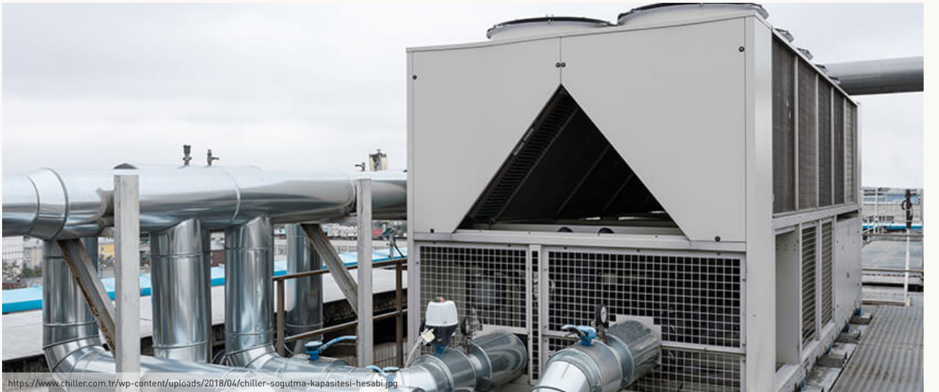
Soğutma Sistemleri (Chiller)
