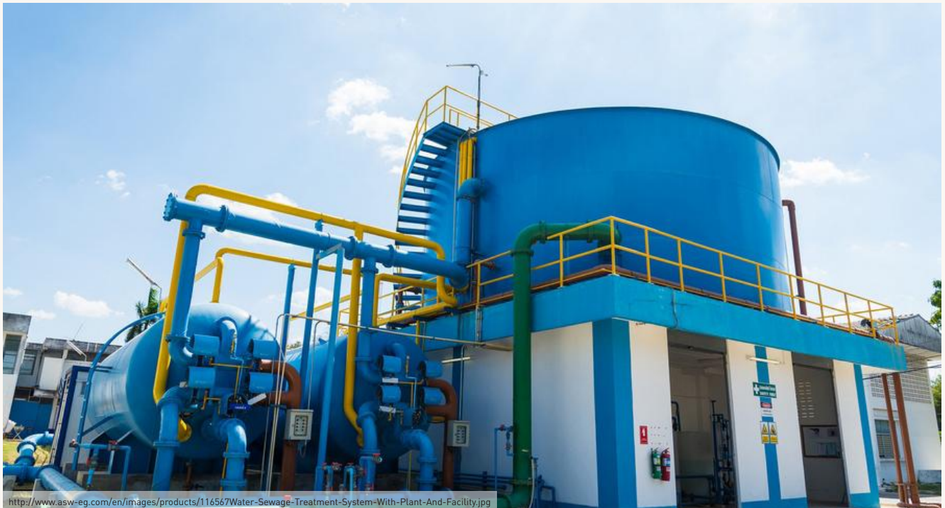
Endüstriyel Atıksu Arıtma Tesisi
