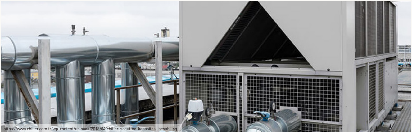
Soğutma Sistemleri (Chiller)
