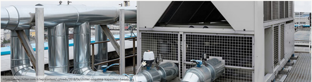
Soğutma Sistemleri (Chiller)
