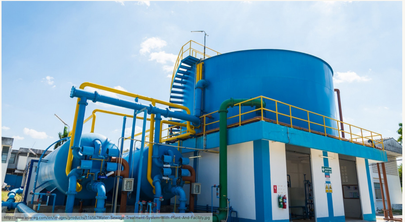
Endüstriyel Atıksu Arıtma Tesisi
